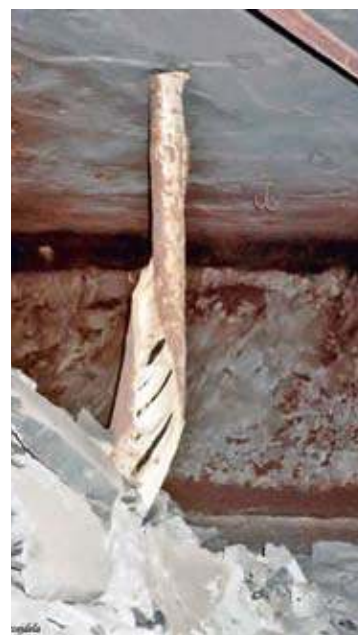
Stojak pękający pod naporem stropu
