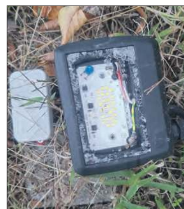
Jedna ze zniszczonych lamp
