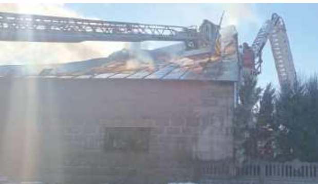
Prawdopodobną przyczyną pożaru było zwarcie instalacji elektrycznej
