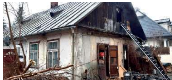
Nadpaleniu uległ dach budynku, ucierpiał także strop i ściany oraz wyposażenie zalane podczas akcji gaśniczej wodą
