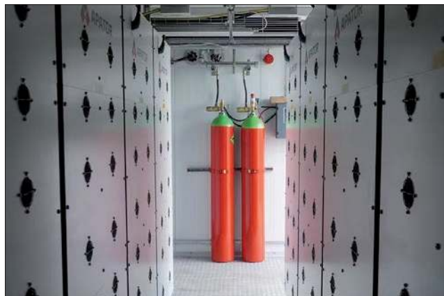
Fot. 2. Wnętrze kontenerowego przemysłowego magazynu energii Źródło: Apator
