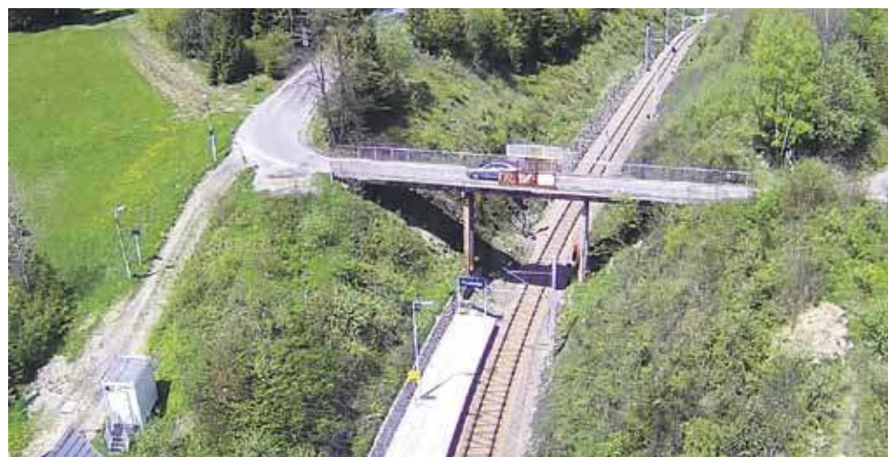
Wiadukt w Pyzówce - obraz nędzy i rozpaczy.
