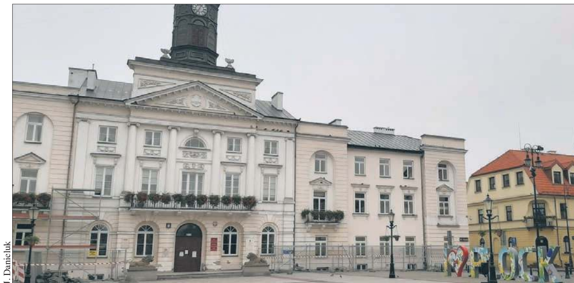
Elewacja głównego budynku płockiego ratusza wymaga remontu. Prace rozpoczęły się w ubiegłym tygodniu
