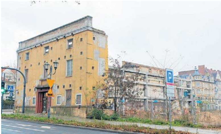
Tak wygląda ruina po kinoteatrze Grunwald przy ul. Warszawskiej
