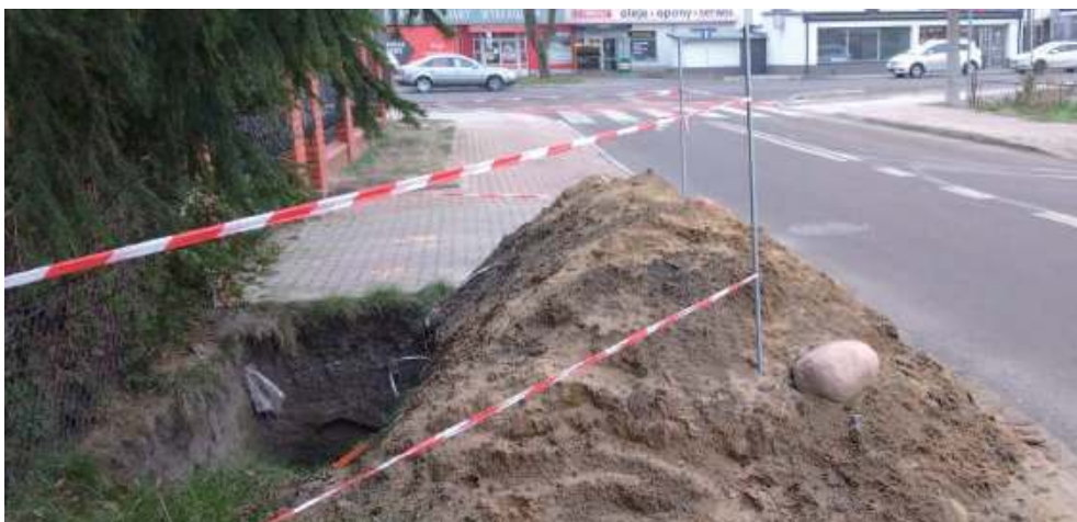
Pan Józef zasygnalizował nam, że na chodniku przy ul. Wesołej od dłuższego czasu leży „kupa piachu”. Przechodnie muszą schodzić na jezdnię. - Tak będzie do wiosny? - pytają mieszkańcy
