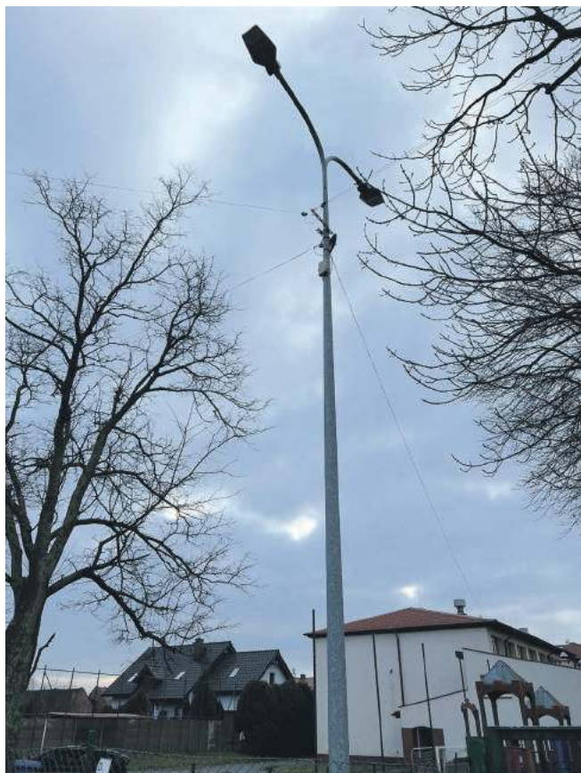
Nowa energooszczędna oprawa LED w Szewcach na ulicy Sportowej
