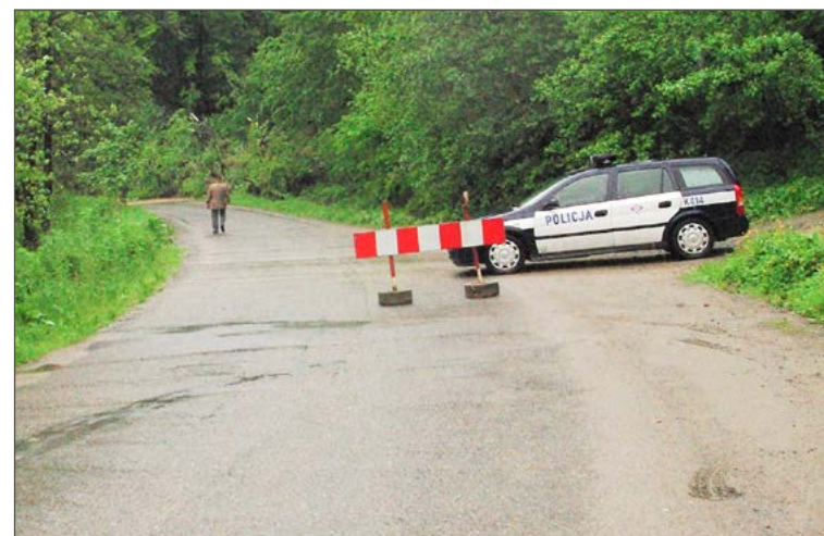
Osuwiska na tej drodze stanowią problem od kilkunastu lat. Fot. arch.
