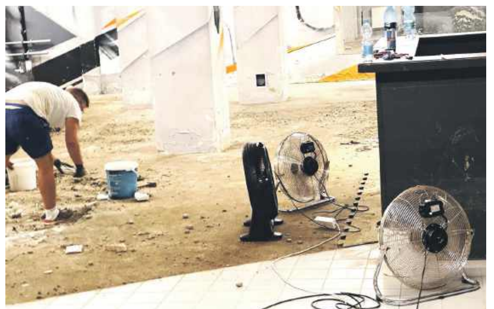
Pomieszczenia zostały zdewastowane
