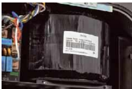
Jeden transformator toroidalny obsługuje obydwie kanały, ale spisuje się bez zarzutu, zapotrzebowanie na maksymalną moc obydwu końcówek przy obciążeniu 4-omowym nie robi na nim wrażenia.
