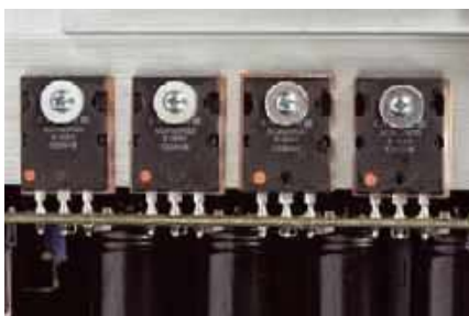
Widoczne na górnej powierzchni tunelu Mosfety to tylko część baterii tranzystorów wyjściowych, kolejne cztery umieszczono przy dolnej ścianie.
