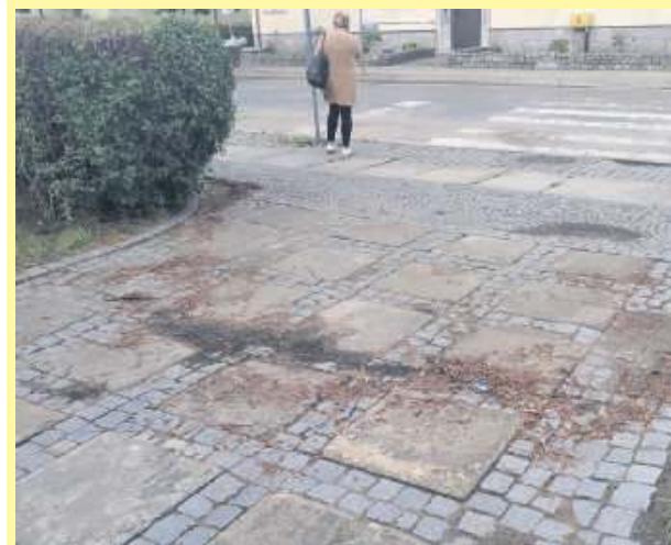
Woda stała na chodniku do wysokości widocznych śmieci
