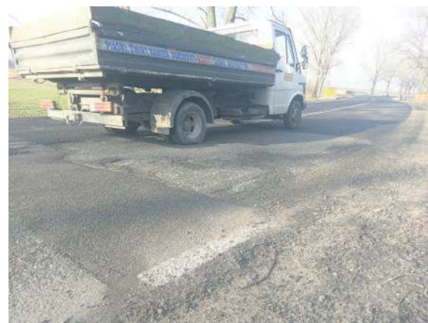
Po remoncie odcinka drogi pozostał niebezpieczny uskok
