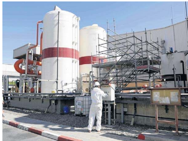
Instalacje odsalania wody morskiej mają strategiczne znaczenie dla wielu krajów Zatoki Perskiej
