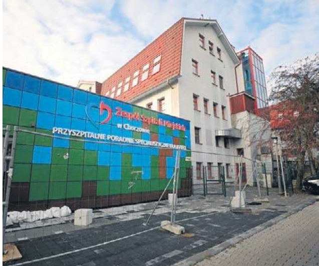
Trwa spór pomiędzy zamawiającym i wykonawcą. PINB w Chorzowie z tego powodu nie dokonał odbiorów
