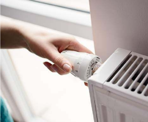
Przed planowanym rozpoczęciem dostawy ciepła należy maksymalnie odkręcić zawory termostatyczne przy swoich kaloryferach. Dzięki tej drobnej czynności unikniemy zapowietrzenia grzejników, podczas napełniania wodą instalacji centralnego ogrzewania
