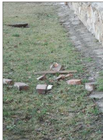
Fragmenty ściany na szczęście spadły na odgródzony teren.
