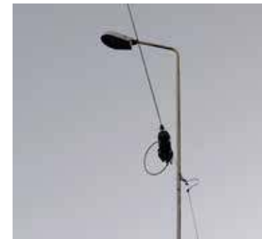
Zerwanie się widocznego na zdjęciu elementu i upadek na chodnik, może skutkować groźną dla przechodniów sytuacją
