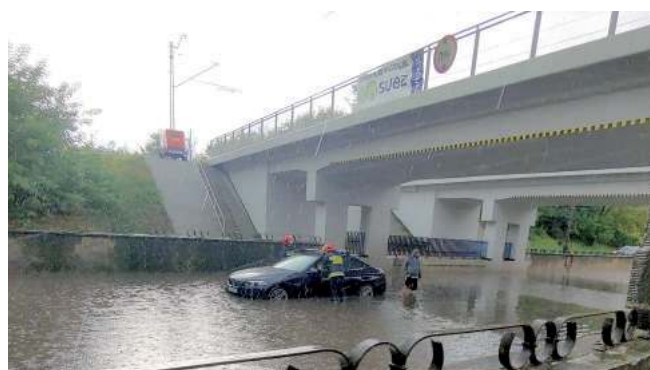
Taki widok pod wiaduktem kolejowym na ul. Partyzantów w Puławach po ulewnym deszczu to nic nowego. Kierowcy mają już dość
