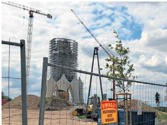
Tak wygląda obecnie budowa pomnika Matki Boskiej w Konotopiu w gminie Kikół
