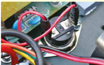
Rysunek 5.18. Okablowanie zasilacza powinno być wykonane z przewodu typu linka, która jest zarówno elastyczna, jak i zdolna do pracy przy stosunkowo dużych prądach występujących w większości zasilaczy.
