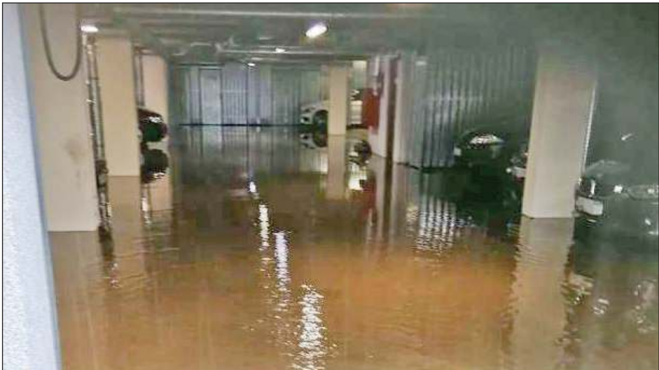
W Garwolinie najbardziej zalane zostały ulice Olimpijska i Targowa, łącznie z garażami w blokach na osiedlach
