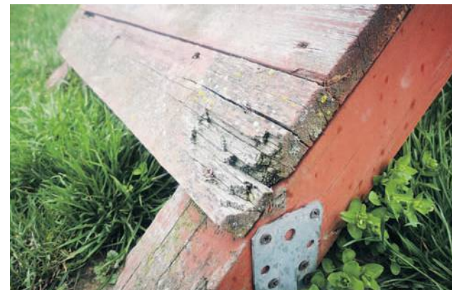
Wiele elementów pilnie wymaga remontu
