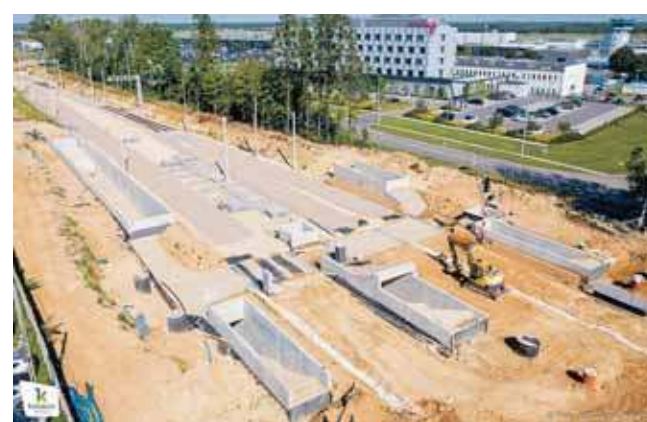
Postępy prac widać m.in. na stacji kolejowej Pyrzowice Lotnisko. Powstają tam dwa perony
