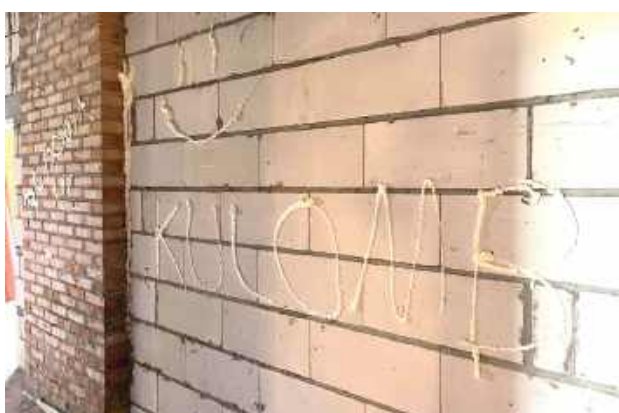
Zniszczono materiały budowlane i naruszono obiekty
