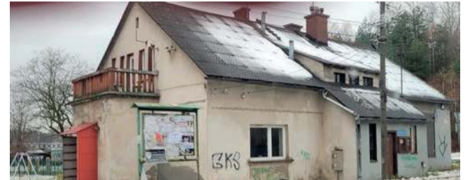
Budynek przy Grunwaldzkiej 53 według ekspertyz jest zużyty w ponad 70 procentach. Pójdzie na sprzedaż lub do wyburzenia
