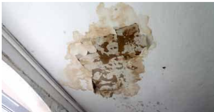
Dach jest dziurawy, więc po opadach deszczu przez sufit cieknie woda i powstają takie wielkie grzyby
