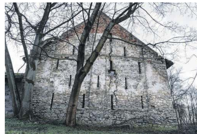
Wschodnia ściana ocalałych zabudowań
