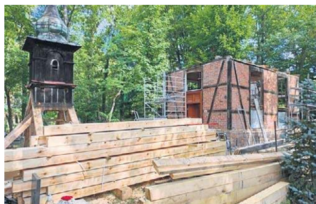
Szkieletowa konstrukcja wymagała remontu
