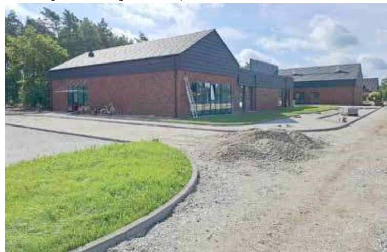
Budynki wymagają ostatnich prac (fot. Sołectwo Kliniska Wielkie)
