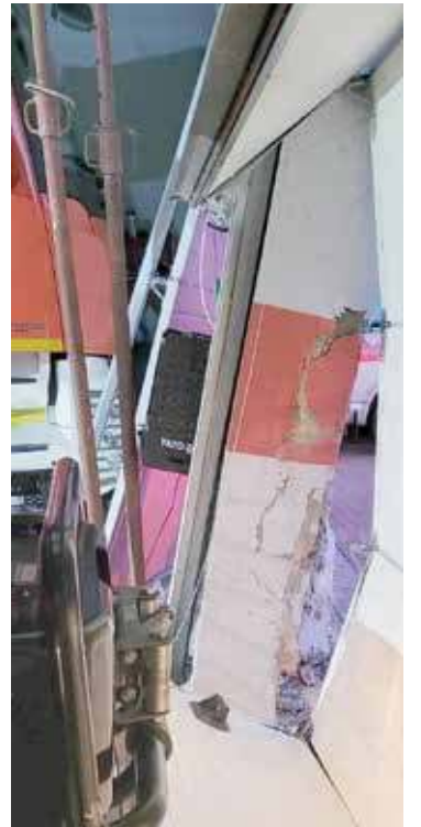
Uszkodzona została brama oraz filar (fot. OSP Lubczyna)
