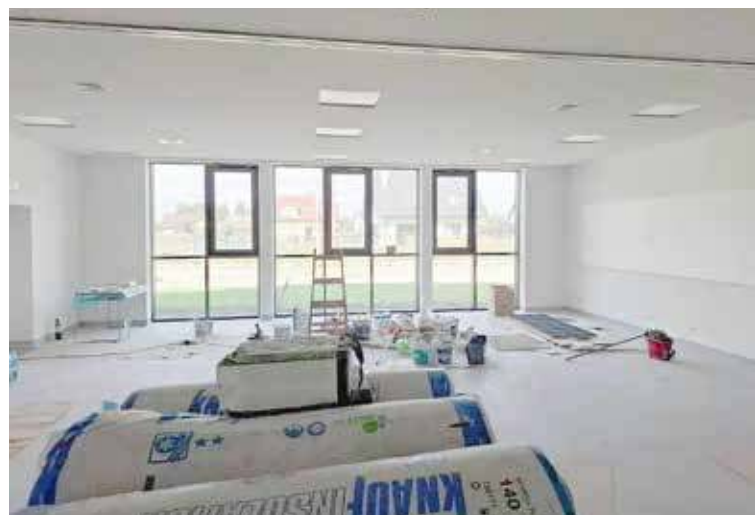
Wewnątrz pomieszczenia wymagają dokończenia (fot. Sołectwo Kliniska)
