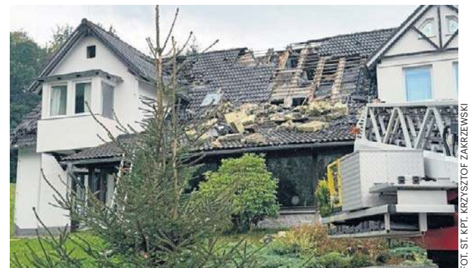
Dogaszanie pożaru trwało do wczorajszego popołudnia
