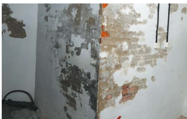
FOT. 2 Widok odpadających tynków i uszkodzeń cegieł; fot.: Zygmunt Matkowski
