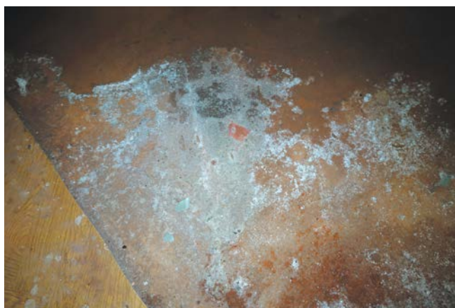
FOT. 4 Widok wysoleń na powierzchni posadzki; fot.: Zygmunt Matkowski
