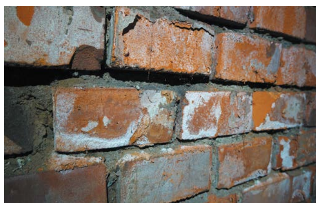
FOT. 3 Widok ubytków zaprawy oraz wysoleń na powierzchni wewnętrznej murów; fot.: Zygmunt Matkowski
