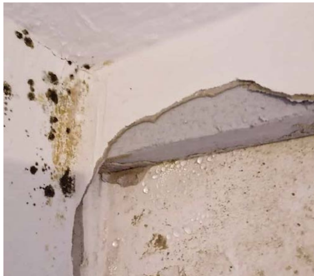
FOT. 4 Degradacja ściany spowodowana wilgocią i dużym oporem dyfuzyjnym warstw na starym murze
