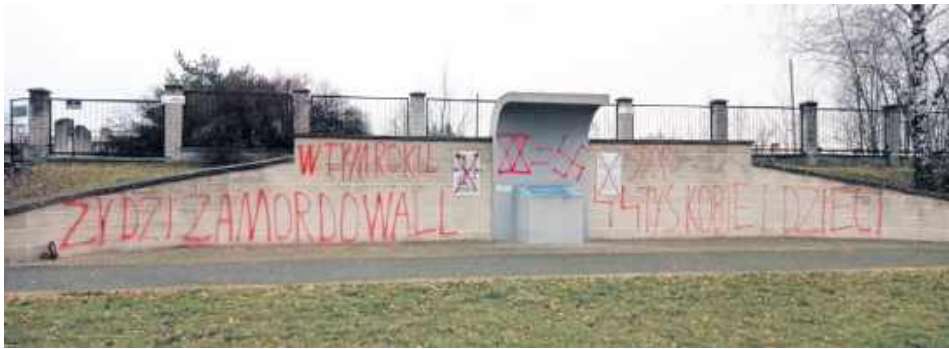
Ściana Pamięci została zniszczona przez wandalów pod koniec listopada 2024 roku.
