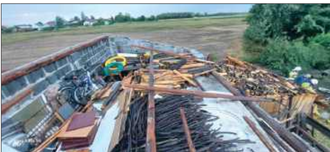
Silny wiatr zerwał dach z budynku gospodarczego.
