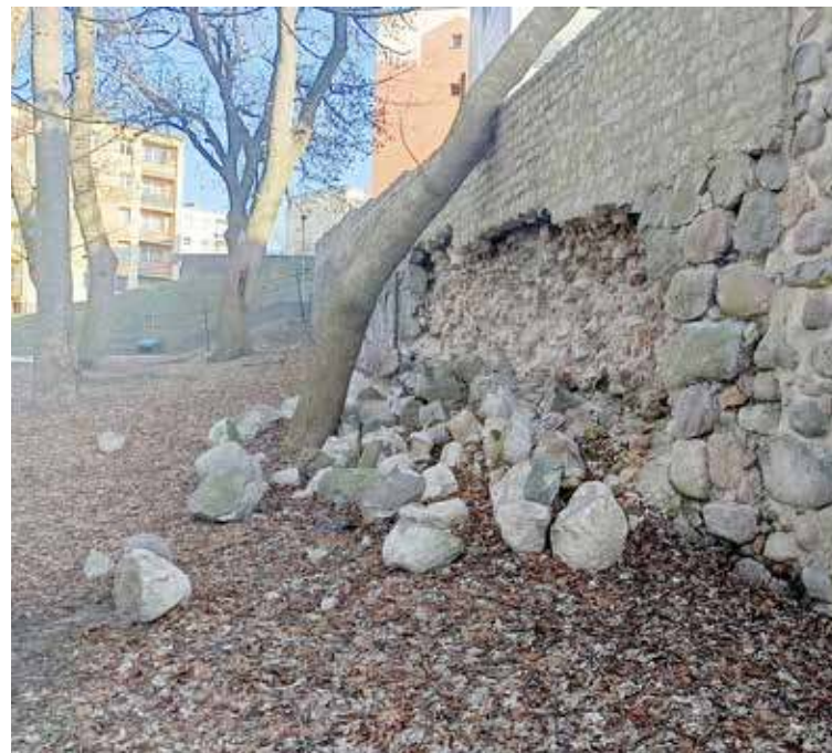
Część muru obronnego zawaliła się w styczniu 2024 r.
