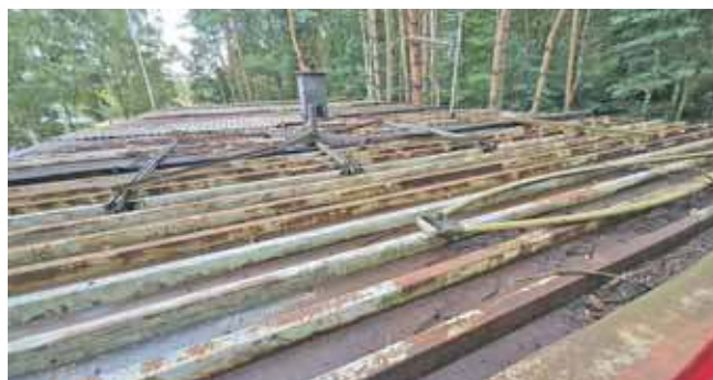
WOPR z Tarnowskich Gór potrzebuje nowego dachu stacyjny nad zalewem Nakło-Chechło
