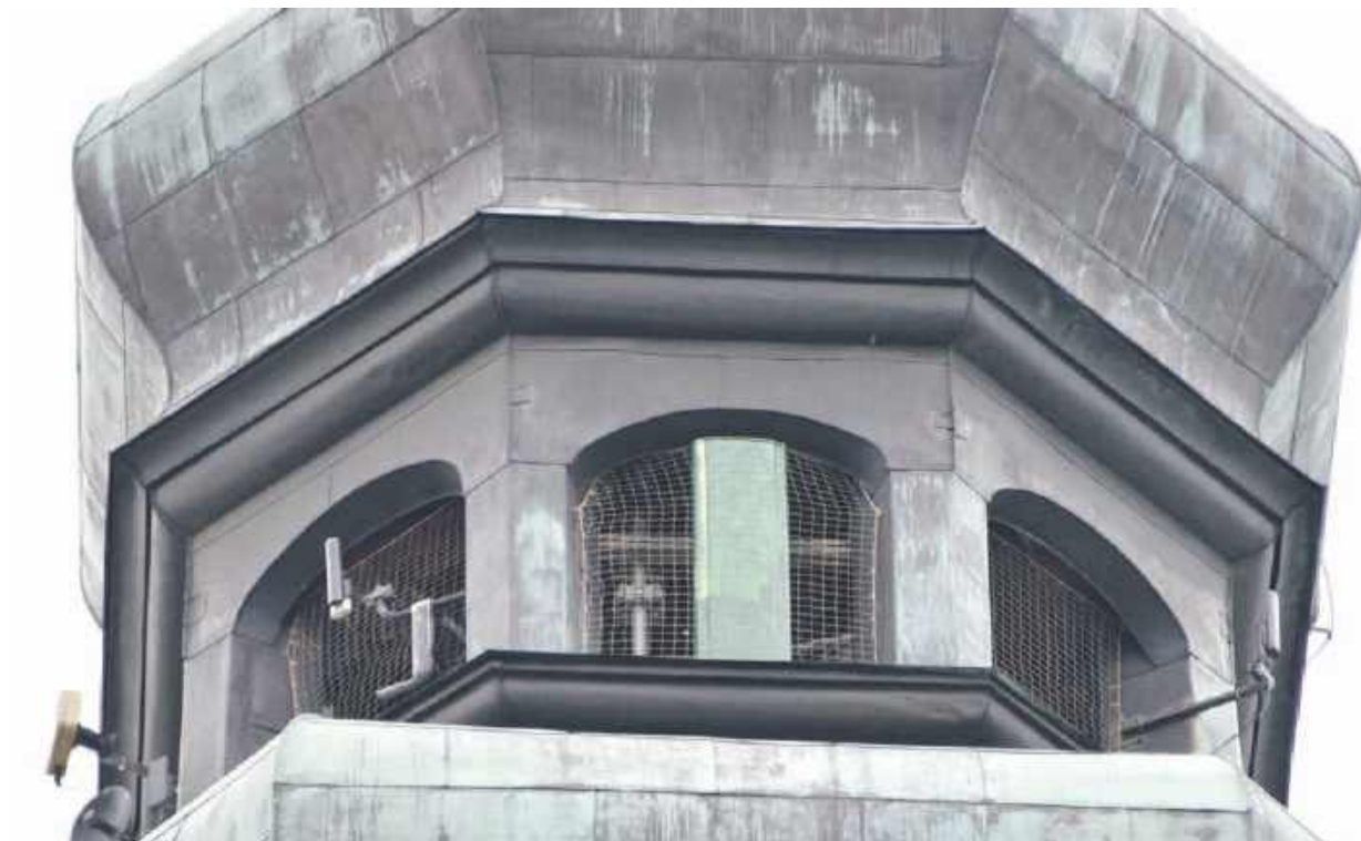
Po interwencjach radnego Pawłowicza i naszych tekstach na wieży zamontowano siatki, które powinny pomóc rozwiązać problem z ptasimi odchodami
