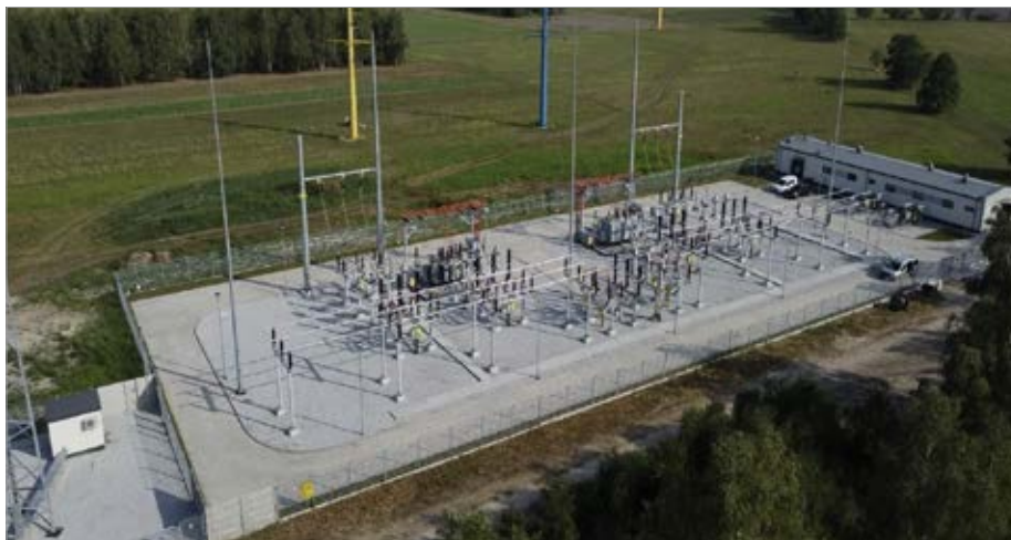
Budowa i modernizacja inteligentnej sieci elektroenergetycznej na terenie Oddziału Warszawa PGE Dystrybucja SA Źródło: PGE Dystrybucja
