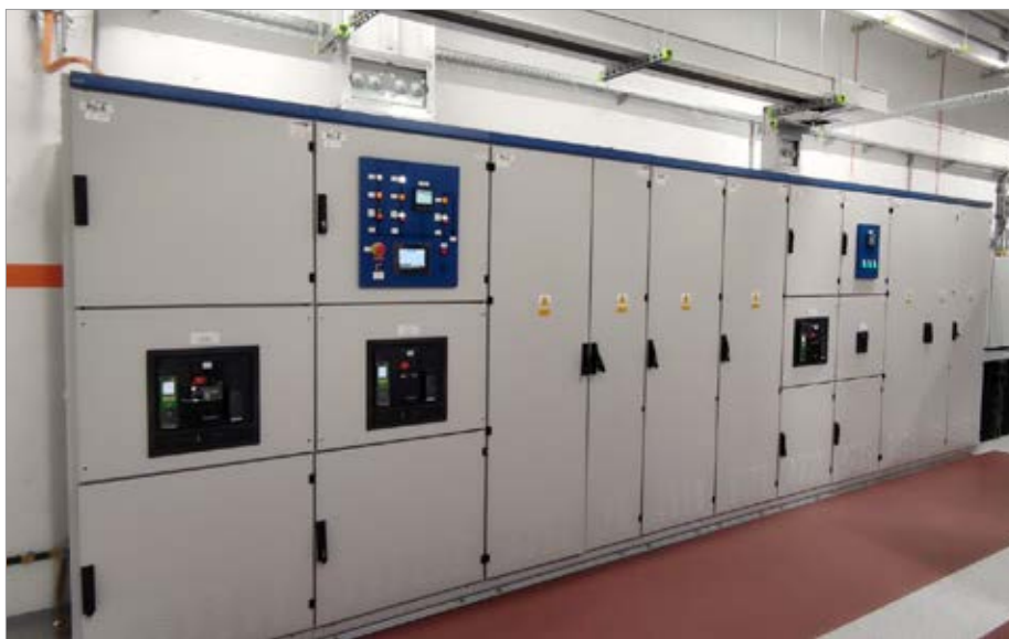
Fot. 1. Zdjęcie rozdzielnicy głównej nn 5000 A w obiekcie Data Center fot. Mariusz Kordeczka
