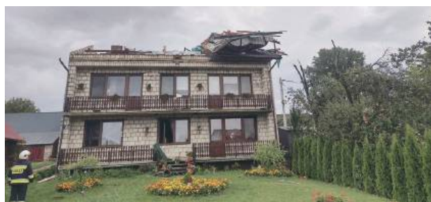
W Podlesiu Dużym silny wiatr zerwał dach z dużego budynku mieszkalnego, a na dodatek – najprawdopodobniej od uderzenia pioruna – doszło do stopienia przewodów i sterownika w instalacji solarnej. Fot. OSP Radecznica
