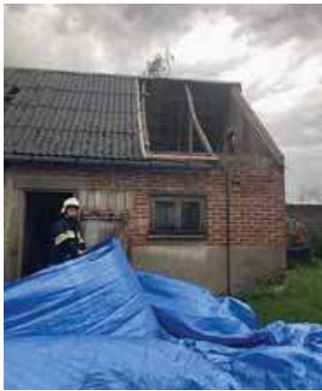
Zerwany dach na stodołę w Szwelicach
