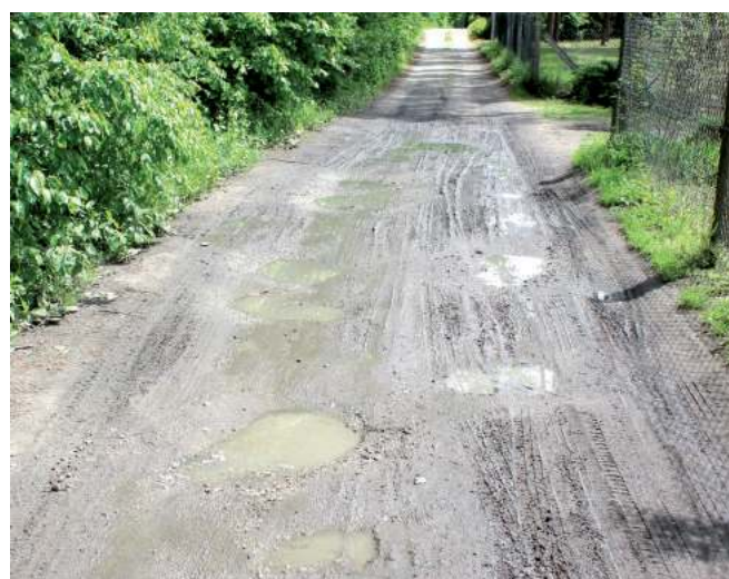
A tak np. po opadach wygląda droga gminna w Kolonii Góra Puławska. Żeby położyć tu asfalt gmina musi przejąć teren od nadleśnictwa. Urzednicy od roku czekają na decyzję Generalnej Dyrekcji Lasów Państwowych w Warszawie
