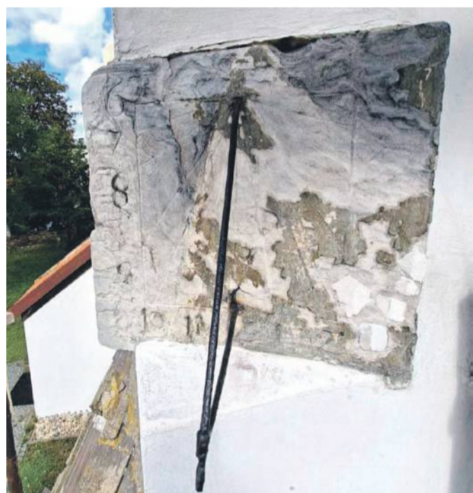
Zegar w Godzikowicach - stan sprzed renowacji
