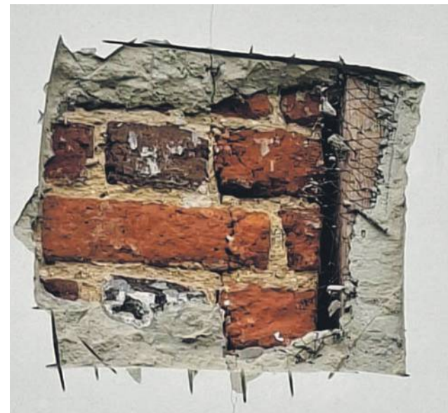
Odkrywką na wschodniej ścianie kościoła w Godzikowicach zachowała pomiędzy ceglami widoczny fragment drewnianej belki. Być może zatem XVIII wieku przy okazji powiększania połaci dachu kościoła mógł być wtórnie rozbudowany
