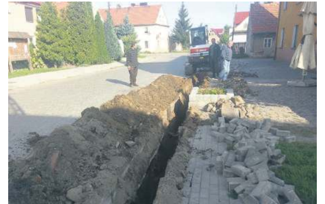
Po rozkopaniu chodnika przez wykonawcę, okazało się, że rura jest niedrożna
