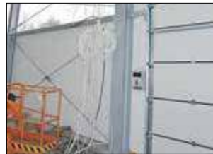
Przewody elektryczne złodzieje skradli z terenu budowanej hali magazynowej.
