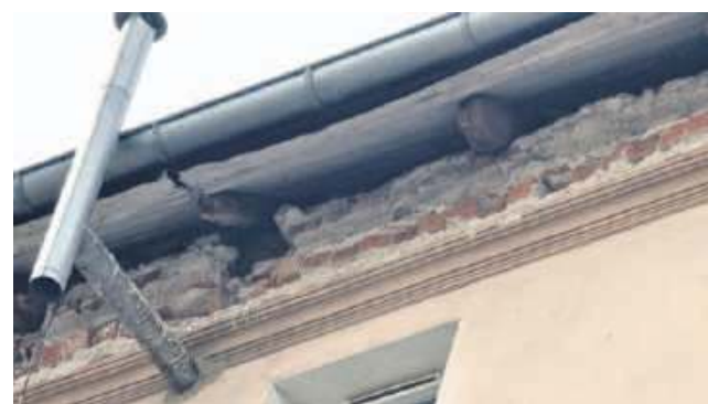
Nie wygląda to dobrze, a na pewno nie jest bezpieczne. Zarządca obiecuje, że zabezpieczy to miejsce
