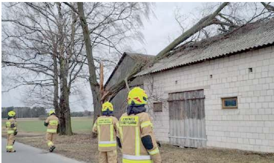
Strażacy mieli pełne ręce roboty. Na zdjęciu drzewo powalone na budynek inwentarski - przy usuwaniu zniszczeń pracowali strażacy z OSP Rossosz
