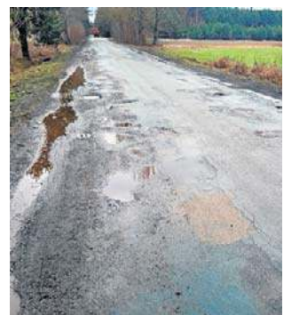
Koszt remontu zniszczonej nawierzchni to ok. 5 mln zł
