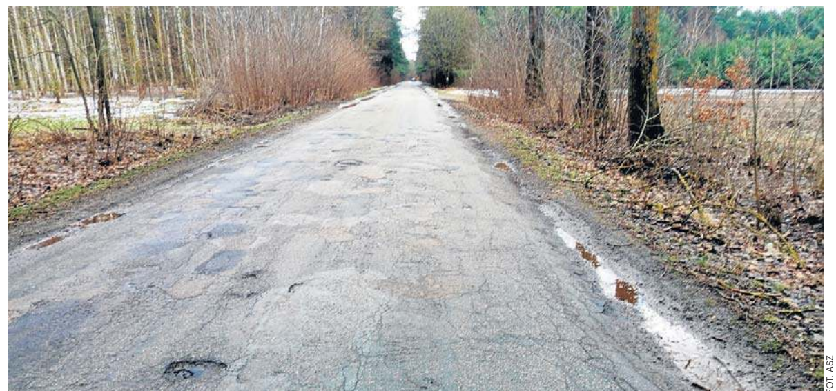
Droga od lat jest w fatalnym stanie, a po ostatniej zimie przybyło nowych dziur w jezdni
