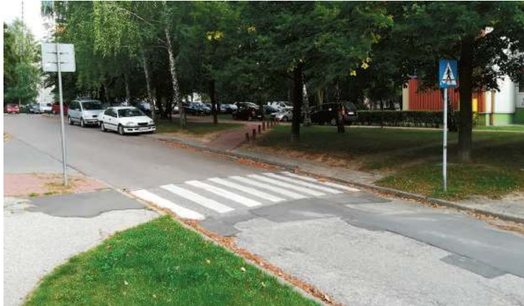
Niepełnosprawni uczniowie chodzący do SP nr 43 z klasami integracyjnymi nadal będą musieli borykać się z krawężnikami na przejściu dla pieszych prowadzącym do placówki
